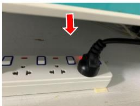
สวิตช์ไฟเปิดเครื่องทำน้ำดื่ม RO
