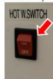
สวิตช์ เปิด-ปิด น้ำร้อน
